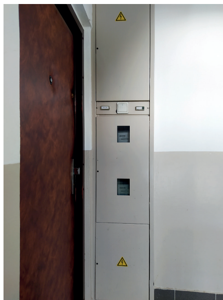
Stúpacie vedenie v panelovom bytovom dome
