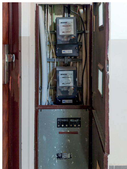
Odbočenie od stúpacieho vedenia, začiatok bytovej prípojky
