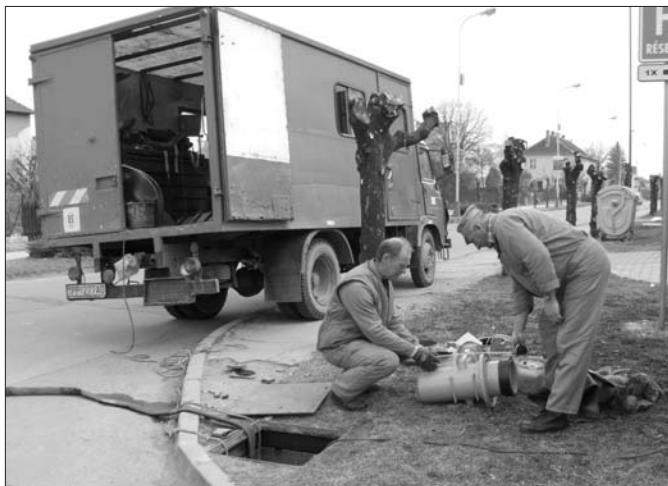
V stredu 2. apríla skomplikovala Sviťanom každodenný život rozsiahla porucha na vodovodnom potrubí, ktorá odstavila pitnú vodu v celom meste už od ranných hodín.
